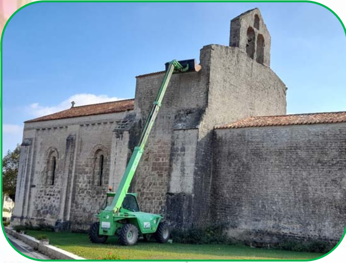
Le 11, l'entreprise de maçonnerie Rolland effectue des travaux sur la toiture de l'église
